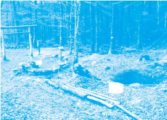
修繕前の崩落状況
