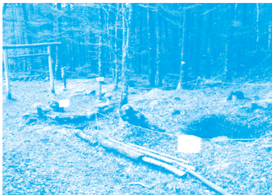
修繕前の崩落状況
